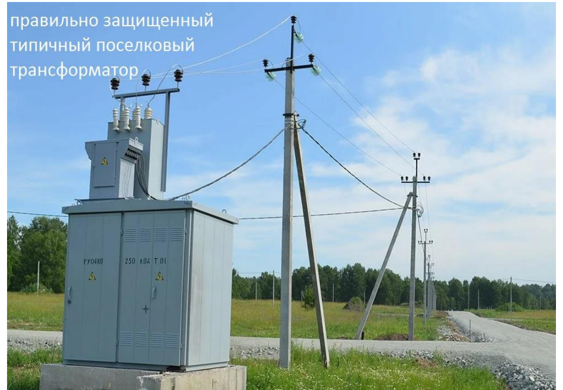
Современный трансформатор с молниезащитой
